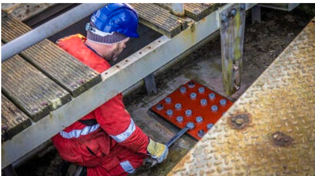
Sluisdeur Bevestiging cilinder aan sluisdeur
